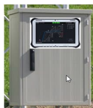
Fixe Installationen im Depotbereich
